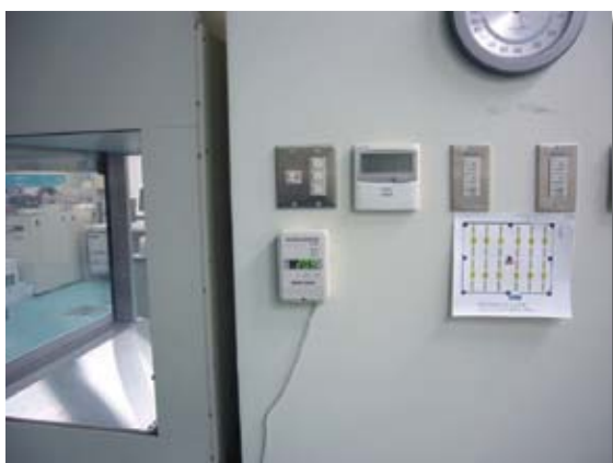
酸素濃度計の設置
