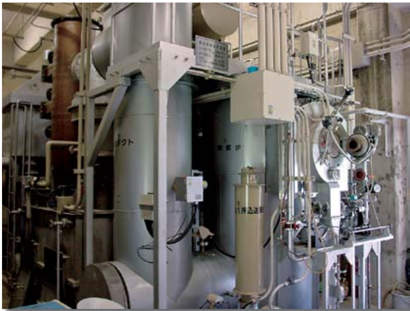
有機廃液焼却処置装置 (焼却炉)
