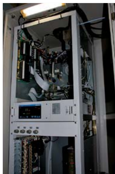
煙道排ガス分析装置
