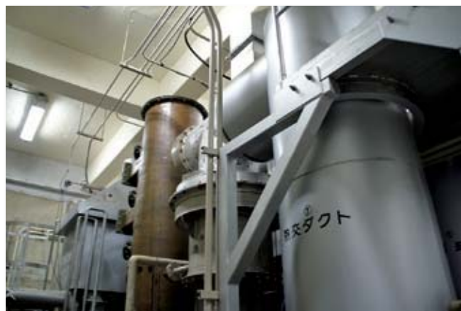
有機廃液焼却処置装置 (排ガス洗浄塔、触媒分解装置)
