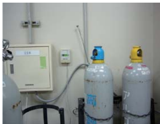
ガスボンベと酸素濃度計
