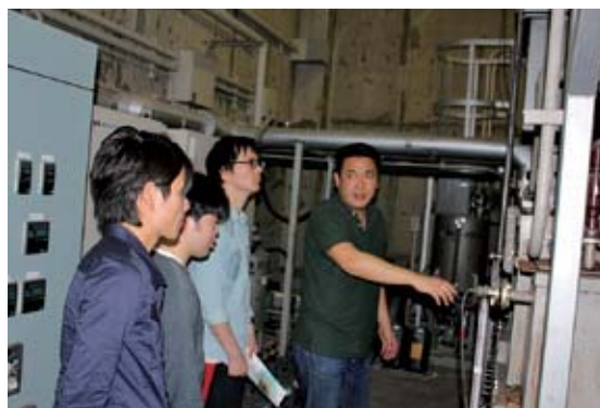
環境科学センター（有機廃液焼却処理施設）での説明
