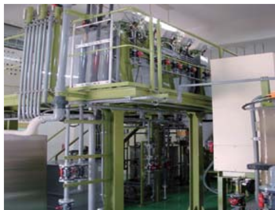
無機廃液処理装置 (鉄粉法)
