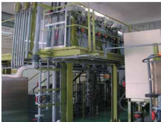
無機廃液処理装置（鉄粉法）
