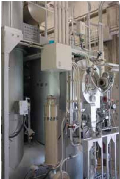
有機廃液焼却炉
