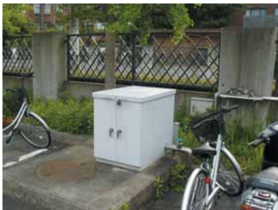
構内排水最終地点（松ヶ崎キャンパス東地点）
