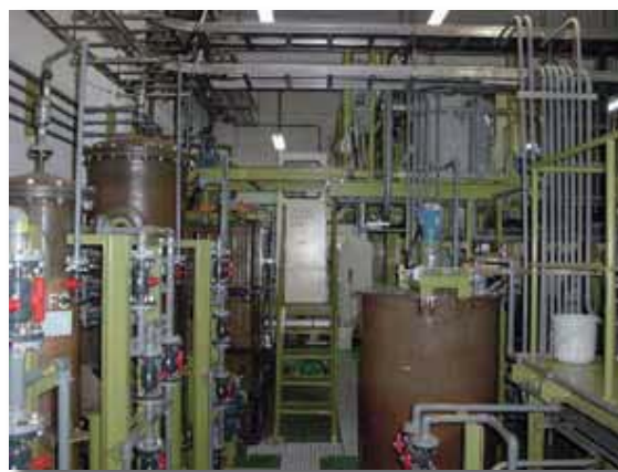
無機廃液処理装置 (同和工管製、鉄粉法)
