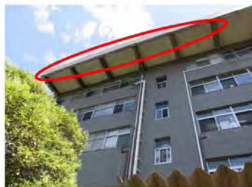
※老朽建物軒庇(築50年)
