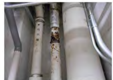
※老朽配管(築50年)
