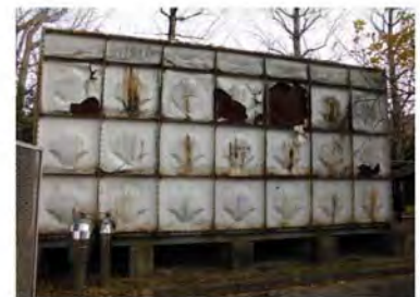
※老朽貯水槽(築50年)
